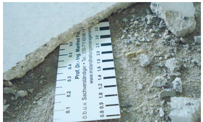
Bild 8: Hohlräume des Estrichs
