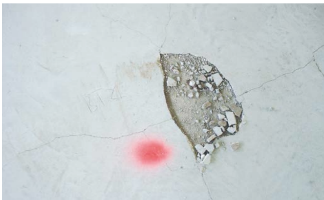
Bild 7: Abplatzen des hohl liegenden Estrichs im Bereich der Rissbildung
