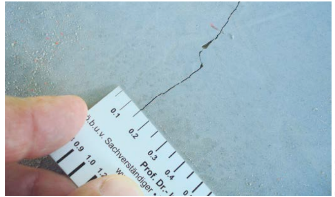
Bild 6: Risse mit Breiten von ca. 0,1 mm bis 0,15 mm
