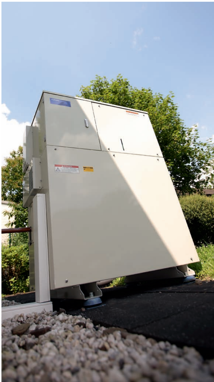
Koppelt Kraft und Wärme, wirkt wirtschaftlich und umweltschonend: Ein Blockheizkraftwerk (BHKW).
